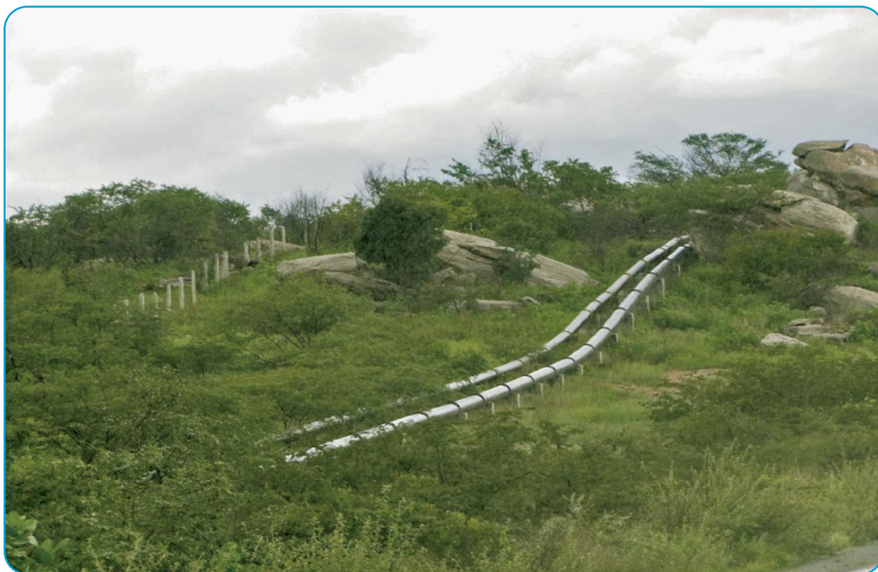
Foto de adutora já existente que será incorporada ao novo sistema
