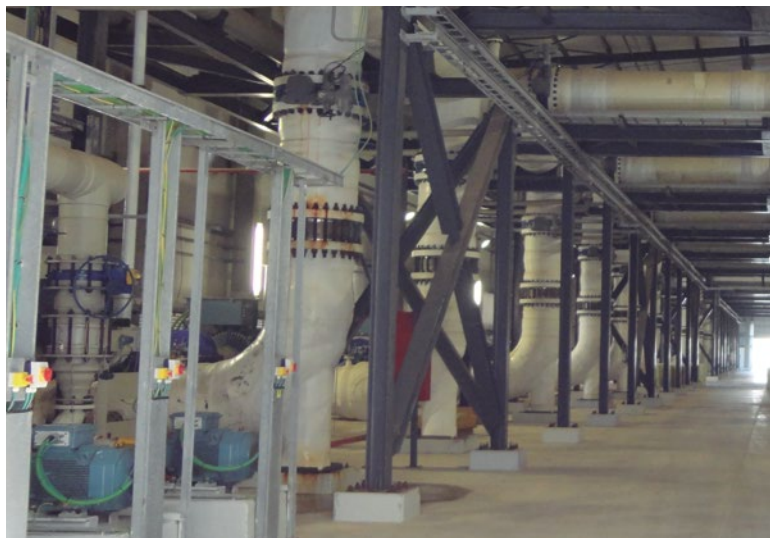
Foto 5 - Tubulações do processo de tratamento de dessalinização.
