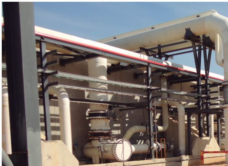
Foto 4 - Tubulações por onde passam a água dessalinizada na Usina Sorek.
