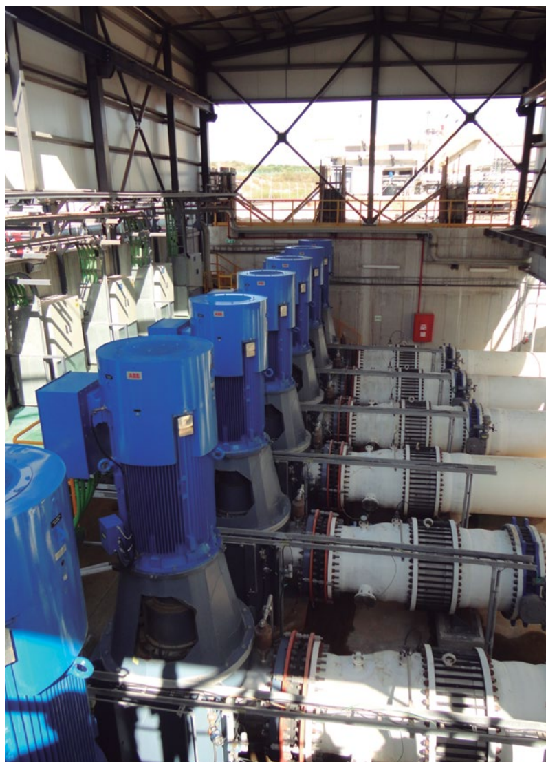
Foto 1 - Sistema de dessalinização por osmose reversa, tecnologia usada em Sorek
