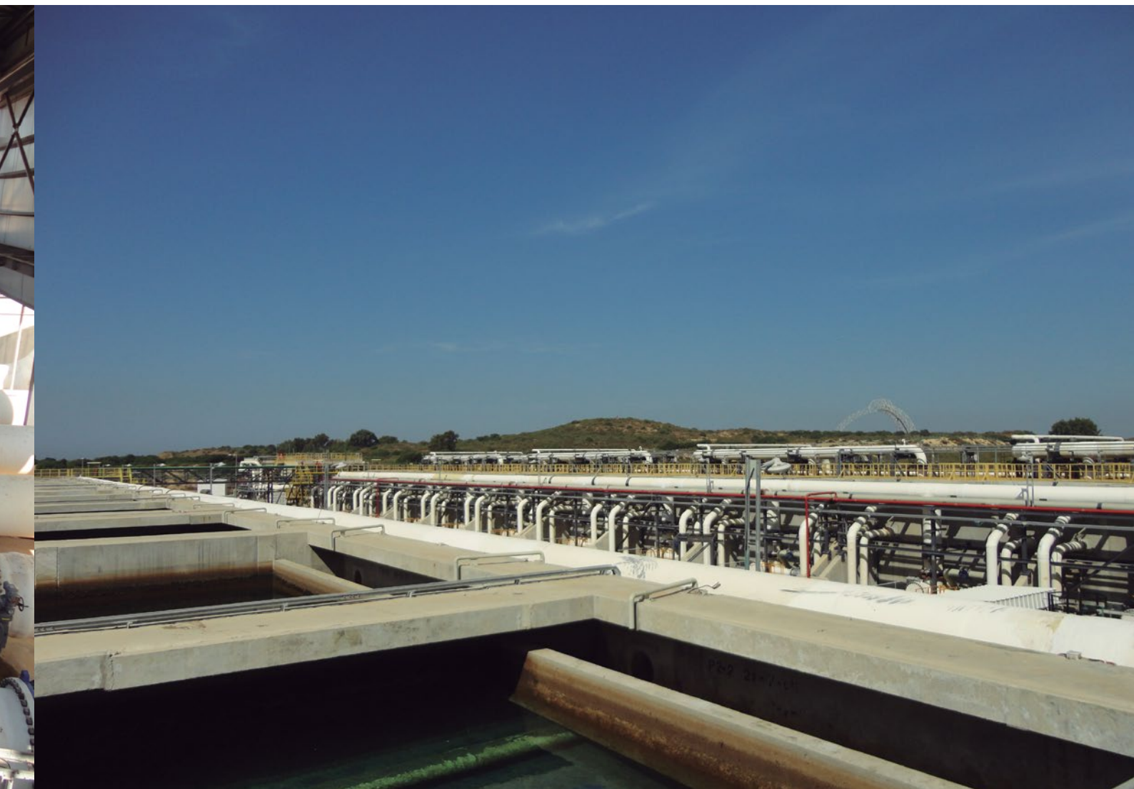
Foto 2 - Tanques durante o processo de tratamento da água dessalinizada
