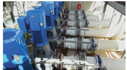
Tubos de tratamento por Osmose Reversa da Usina Sorek, a maior usina de dessalinização de Israel
